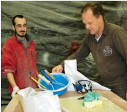
Tissu, résine, colle et rouleau : le nécessaire pour réaliser les joints congés.
